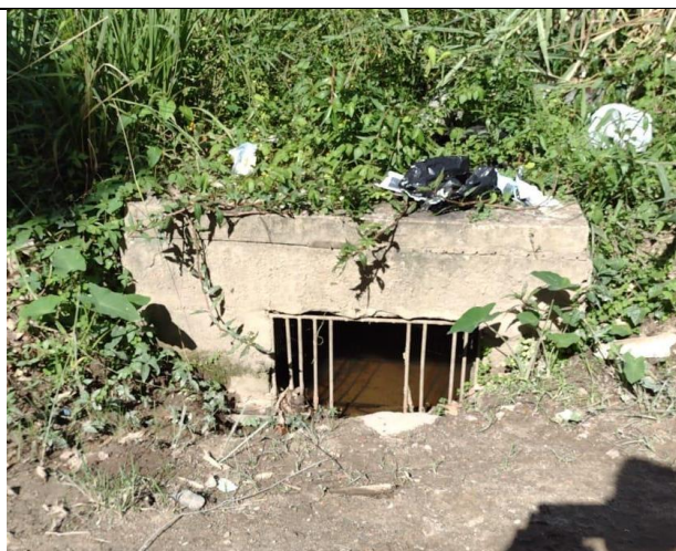
Foto 12 Captação e canalização de curso d'água oriundo de nascente na Rua Itaberaba.
