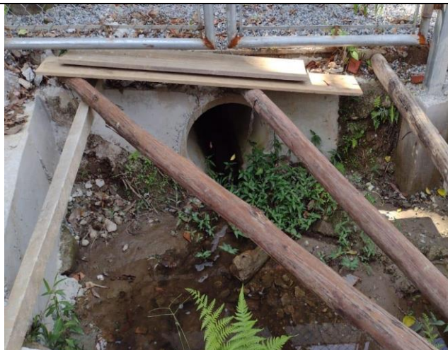
Foto 08 Canalização de curso d'água oriundo de nascente cruzando a Rua Itaberaba alt. nº 37/625.
