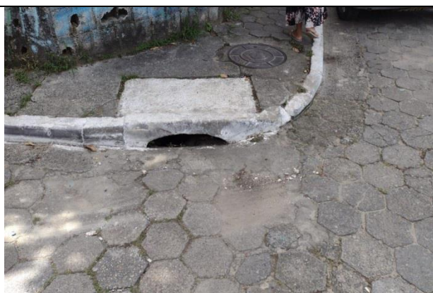
Foto 28 Dispositivo de captação existente na Praça da Alegria
