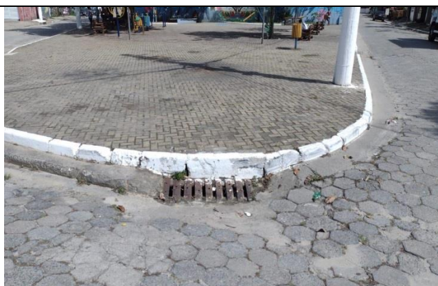
Foto 27 Dispositivo de captação existente na Praça da Alegria
