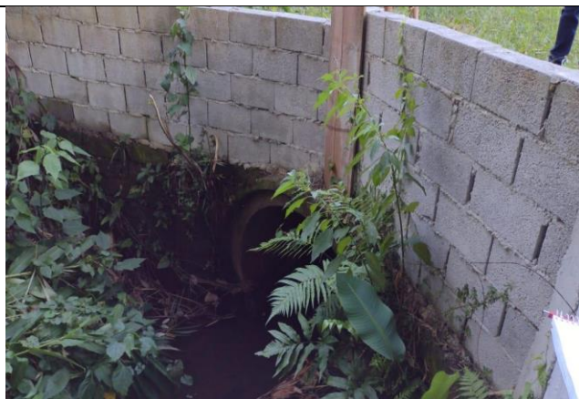
Foto 20 Travessia de canal à montante do campo de futebol.
