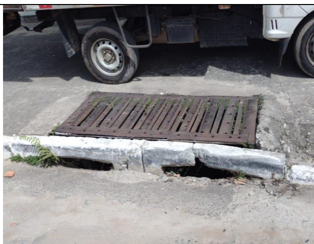
Foto 30 Dispositivo de captação existente na Rua Benjamin Manoel dos Santos.
