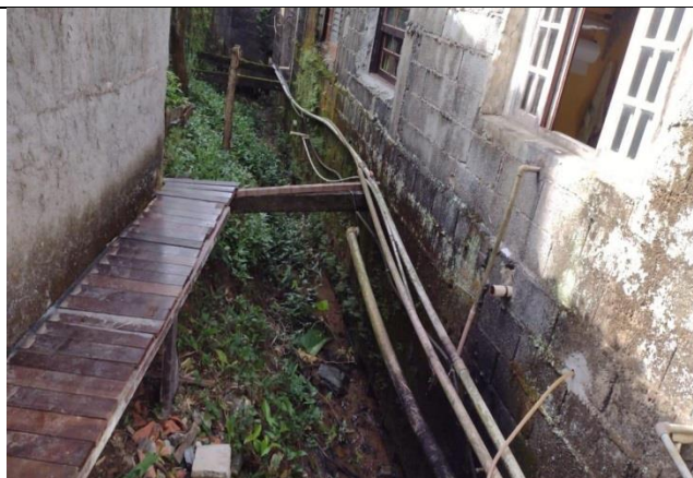
Foto 26 Curso d'água estrangulado nos fundos de edificação em Travessa da Estrada da Maquininha.
