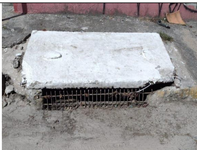
Foto 29 Dispositivo de captação existente na Rua Benjamin Manoel dos Santos.
