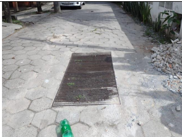
Foto 02 Dispositivo de captação na Rua Antonio Ledo dos Santos.
