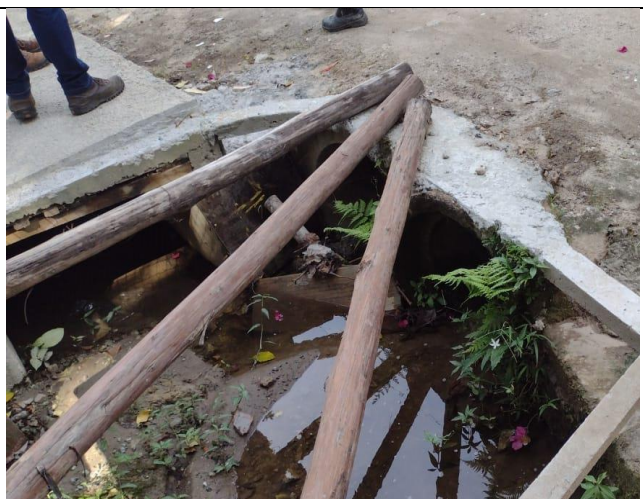
Foto 09 Travessia de canalização de curso d'água oriundo de nascente na Rua Itaberaba nº 37/625.
