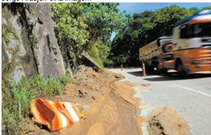
Acima, faixa interditada no km 49 da rodovia dos Tamoios
