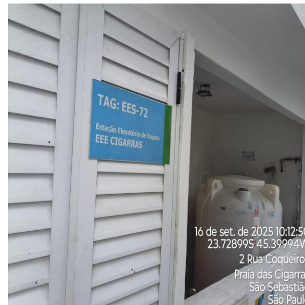
TANQUE DE ARMAZENAMENTO DE CLORO
