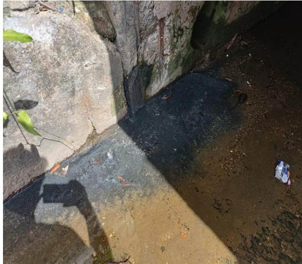
LOCAL DO VAZAMENTO - ANTES
