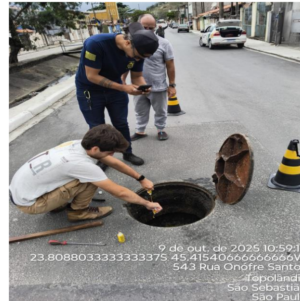
Teste de corante com confirmação de que se trata de efluente da rede.
