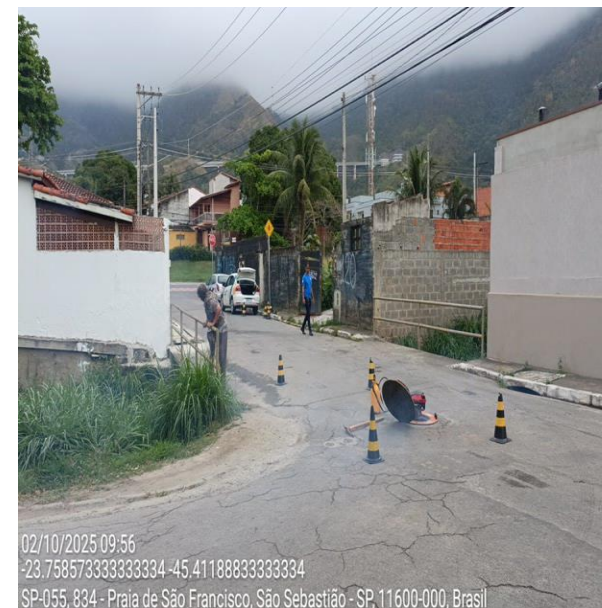
Vazamento de esgoto embaixo da ponte.
