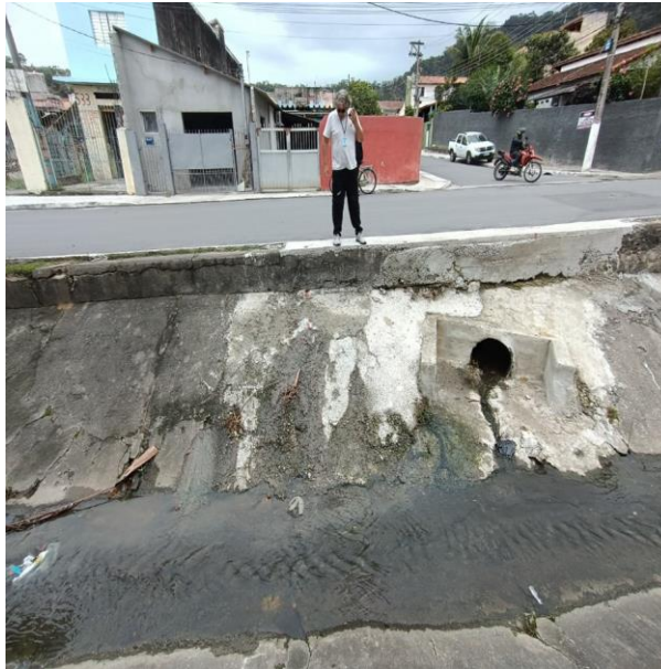
Vazamento de esgoto
