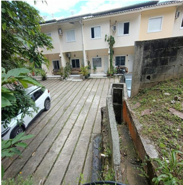
Passagem de água de drenagem pelo bloco do condomínio
